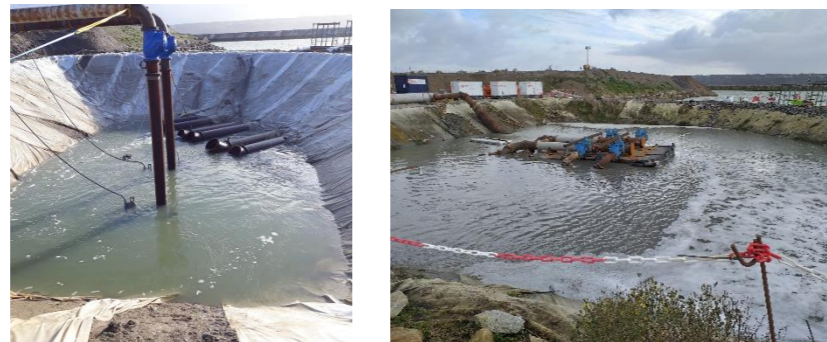
Figure 2 : Exemple de bassin de décantation des rejets
